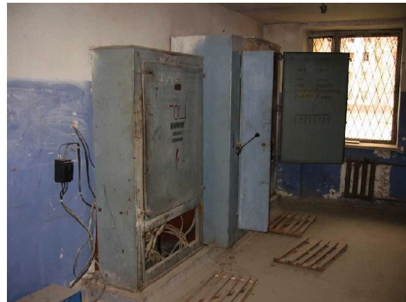
電気室の受電盤と主分電盤
