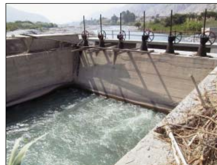
Compuerta de Desfogue de Fondo en la Bocatoma de Nuevo Imperial
