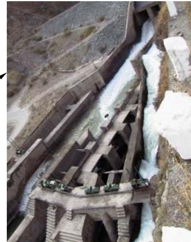
Vista General de las Obras de excedencia del Tranque de regulación de la Central Hidroeléctrica Huinco
