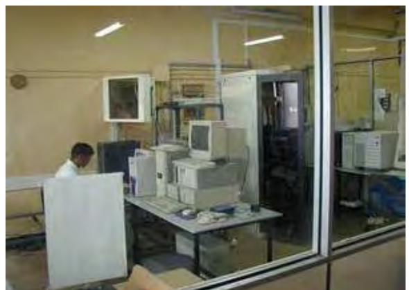
ホストコンピュータ室（データ通信実験室内）
