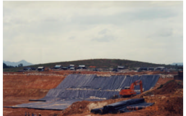
セクション2の満杯を迎え、現在は、第2期に予定される他セクションで遮水シートの敷設工事が急ピッチで進められている。
