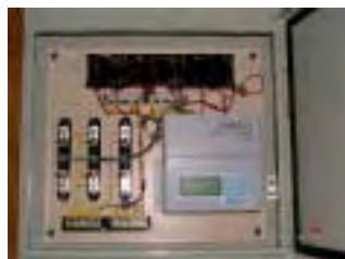
-- Data Logger box --
