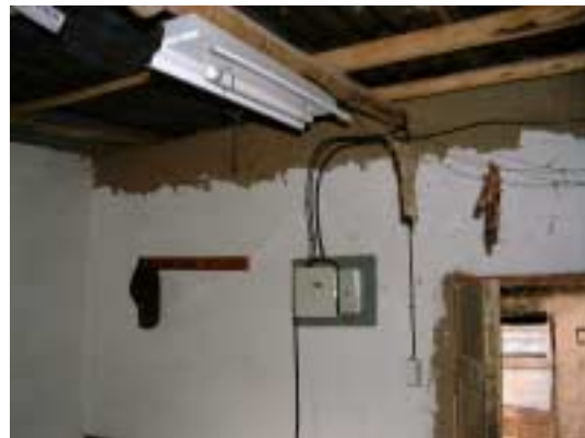
設置した蛍光灯
