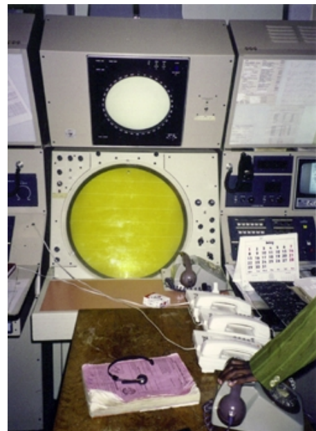
交換された新しい航空管制レーダー
