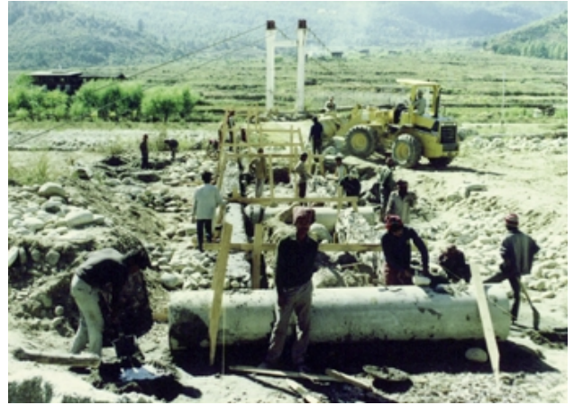
無償資金協力によって建設された橋への接線通路が、引き渡された機材を活用して整備されている
