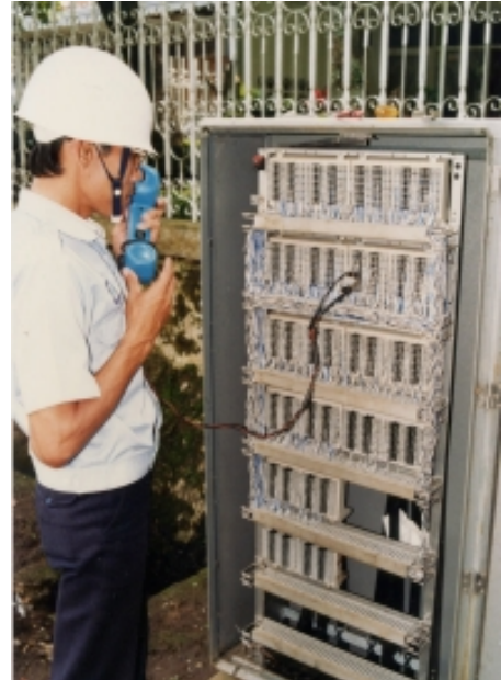
電話交換機の点検を行うカウンターパート
