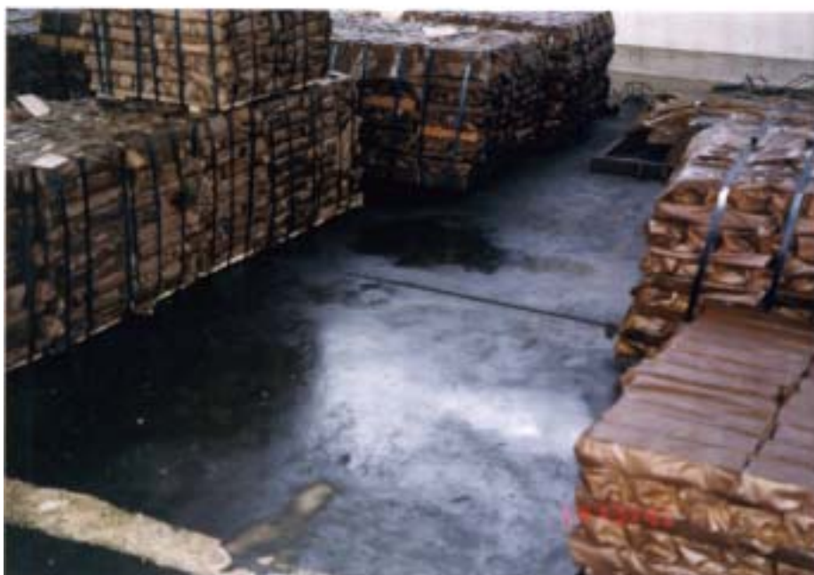
写真1 - 1 0 - 1 材料倉庫床面（改善前 床面にオイルが溜まっている）
