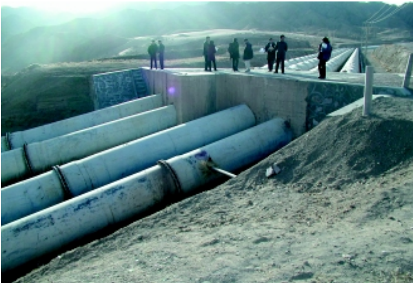
甘肅省景泰川灌漑区基幹水路 (パイプライン、本プロジェクトにおいて流量を計測する)
