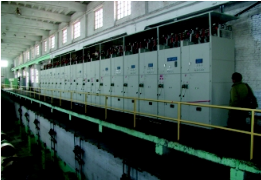
甘肅省景泰川灌溉区ポンプ場操作盤 (本プロジェクトのため中国側により操作盤が更新されている)
