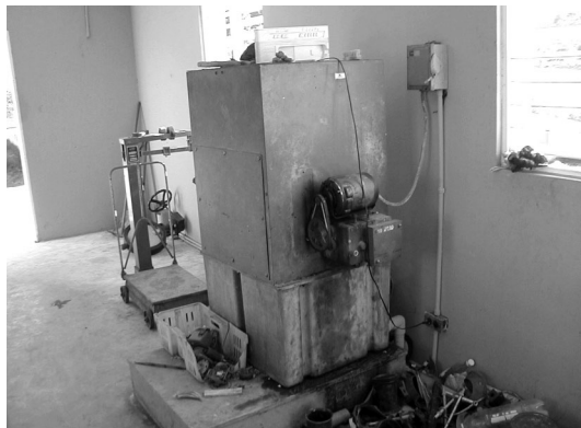
壊れて放置されたままの硫酸バンド注入器(粉体注入式)
