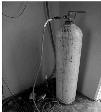
塩素注入器が壊れ、ポンベから生ガスで注入 注入点周辺にガスが漏洩し、施設に影響を与える
