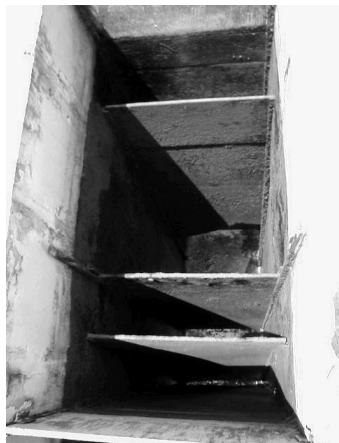
フロック形成池: 迂流板の50%は破損している
