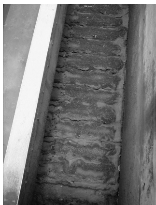
ろ過池逆洗後に生じる砂層の亀裂 砂層全体が洗浄されていない
