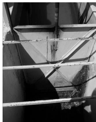
ろ過池配水ゲート漏水が多い
