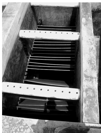
沈殿池: 破損・脱落した傾斜板
