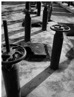
錆びて作動不能になったろ過池ゲートと鉄製人孔蓋
