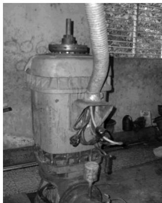
取水ポンプ: 他から流用されたもので容量不足
