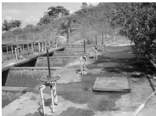
ろ過池ゲート操作台、錆付きがひどく操作不能のものがほとんど 漏洩塩素ガスの影響が大きい
