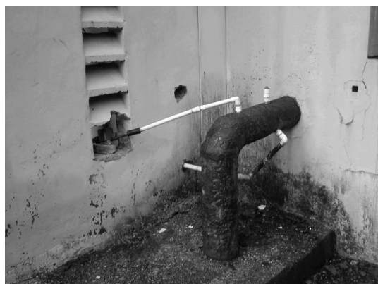
塩素注入点: 漏洩塩素により周辺に腐食が見られる
