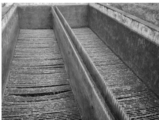
沈殿池傾斜板: わん曲脱落があり、表面が溶出
