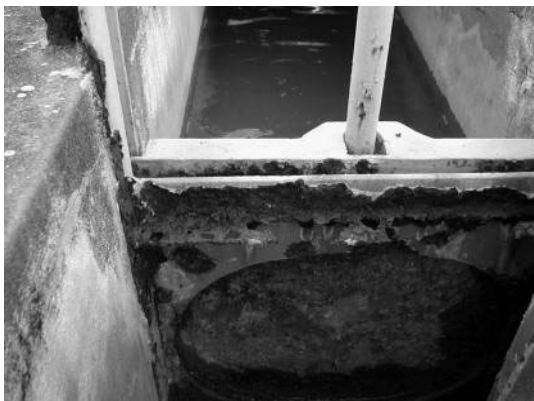
ブロック形成池ゲートバルブ: 腐食が著しく進んでいる 漏洩塩素ガスと硫酸バンドによると見られる
