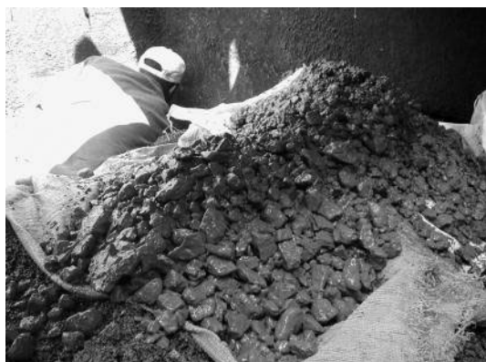
ろ過池砂利層：逆洗能力が低いため、濁質が蓄積している
