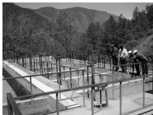
浄水場バルブ操作台：一番右端のろ過池流出ゲートバルブの操作台が錆付いて回らない
