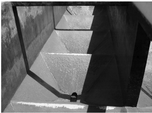
沈殿池排泥ビット: ドレーン管の排水が悪い
