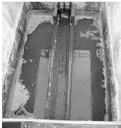
十分な逆洗速度が得られないろ過池
