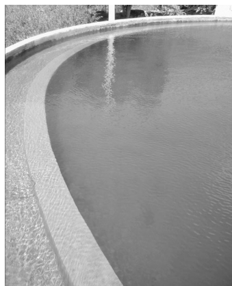
沈殿池集水トラフ越流してしまい、池内に短絡流ができ沈澱効果低下
