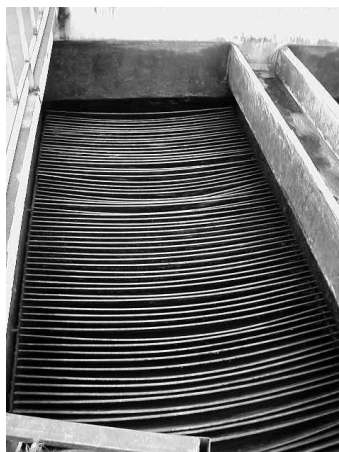
フロック形成池: アスベストセメント製傾斜板、湾曲が進んでいる
