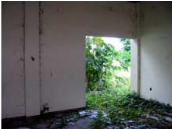
Classroom 1-2 : No door frame.
