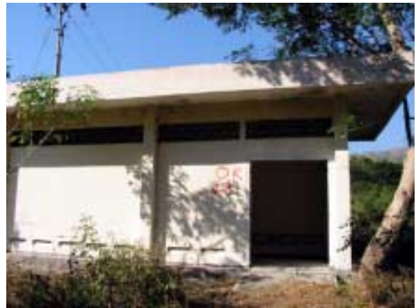
Electrical room : No door
