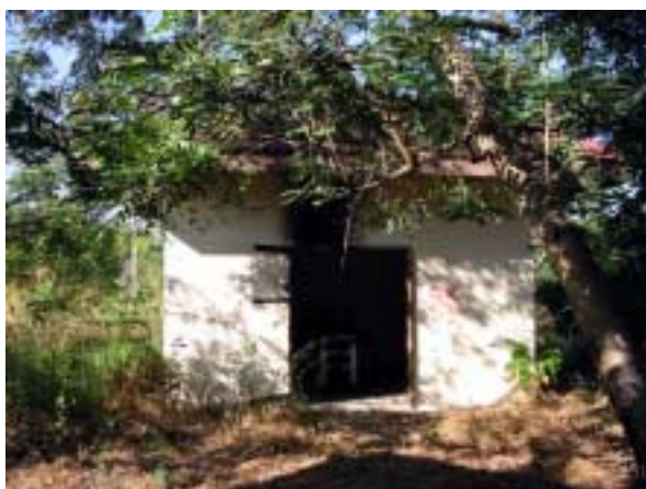
Transformer room : No door
