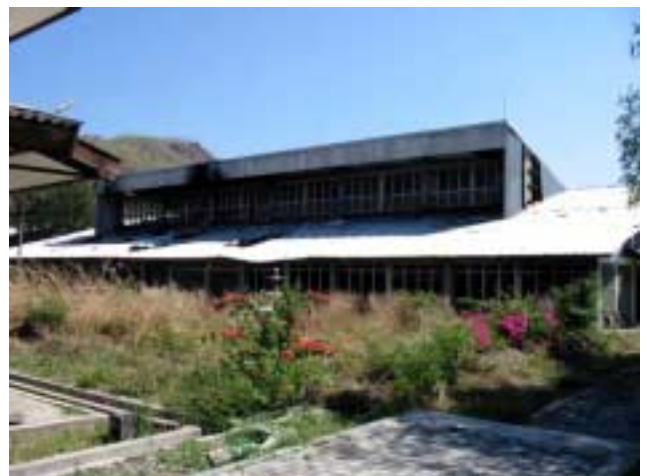
土木ワークショップ：改修を行う建物。改修後 土木ワークショップになる。
