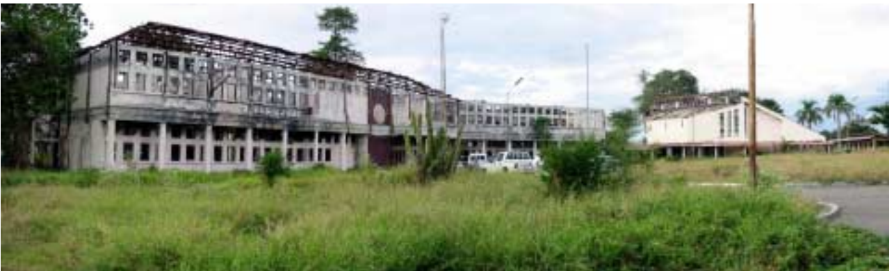
左側 - 管理棟：解体を行う建物。書類など燃える物が多かったため火災被害が大きく、解体を行う。 右側 - 講堂：改修可能な建物。屋根は燃え落ちているが燃える物が少なかったため、火災被害は小さく改修可能。
