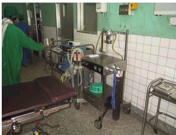
麻酔器は医療ガスの漏れ、一部機能の故障。
