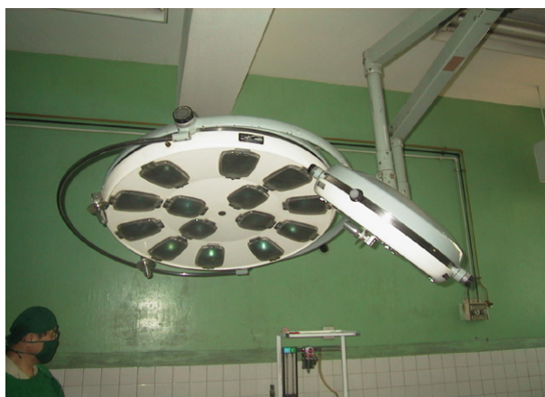
无影灯は内部腐食により一部点灯しない。
