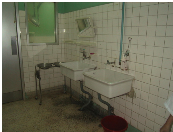
手術室の手洗台。フィルターは一切ない。
