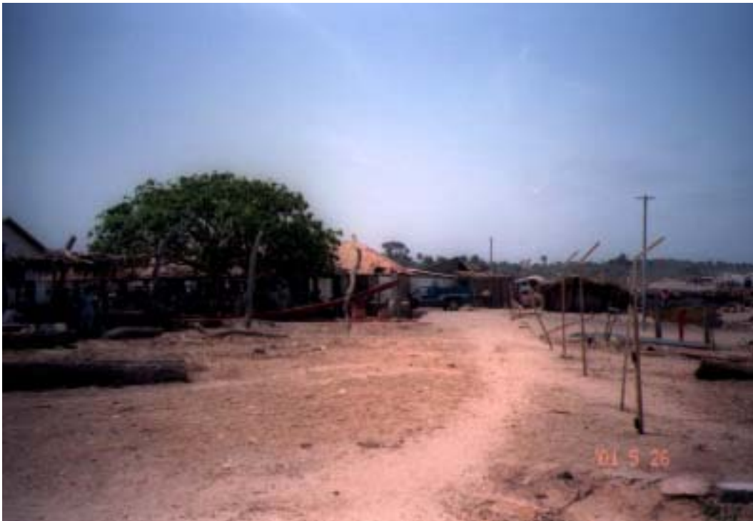
サイトの現状（２）：右側サイトの右端部の現状を陸側より望んでいる。本プロジェクトにおいて漁具倉庫、ワークショップ等が建設される予定である。
