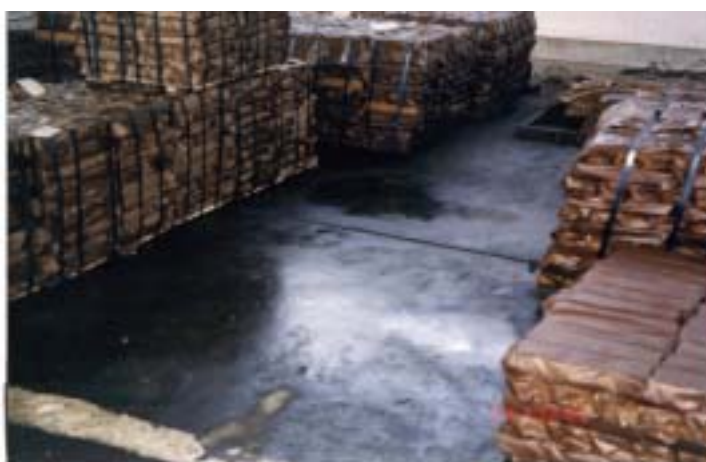
写真 3 - 2 - 2 床面の油漏れ状況
