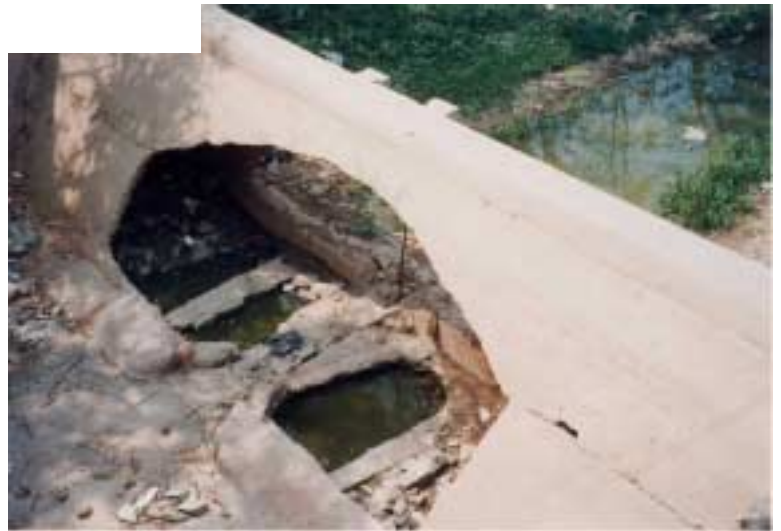
上流側水叩きの固定堰部分。人為的に一部分は壊され、ゲート基礎部分の土砂の吸出しが進行している。
