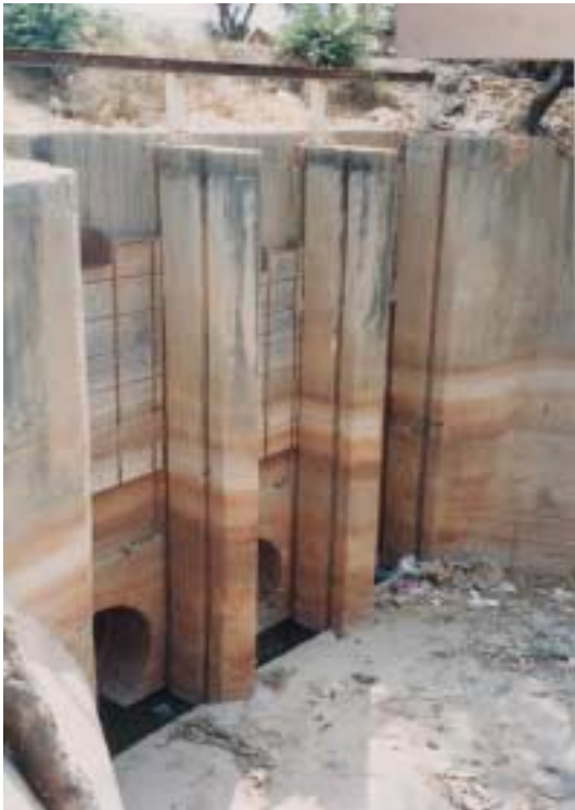
排水樋管上流側ゲート。 木製ゲートで著しく老朽化し、水密性は悪い。
