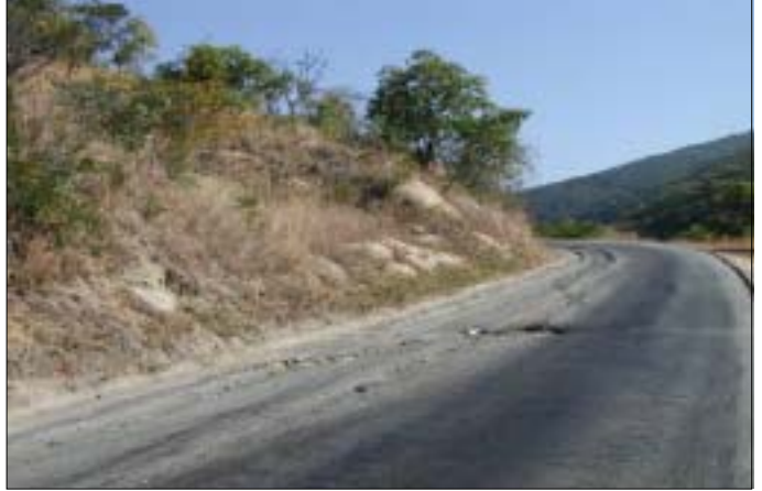
キトンガ峡谷の舗装 (KP 442) 登り側車線では最大15cmの深さの 轍掘れが発生している
