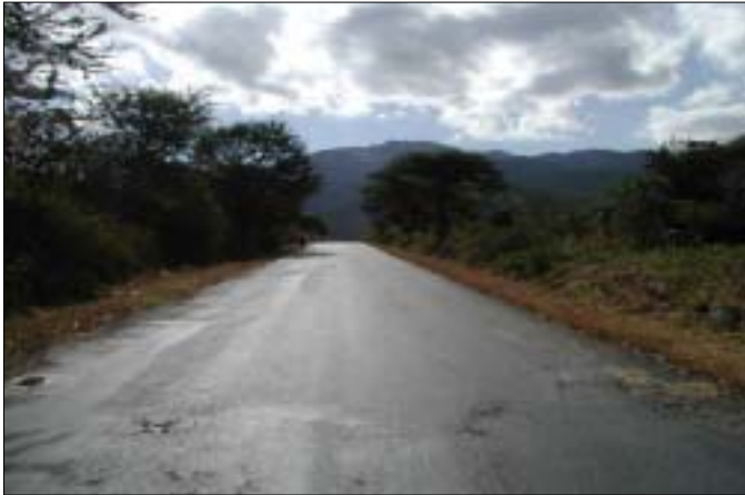
キトンガ峡谷手前の舗装 (KP 438+500) アリゲーター状のクラックが発生している
