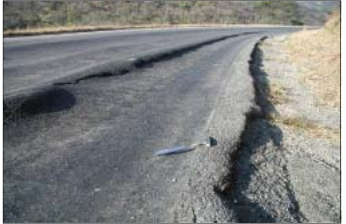
アスファルトの流動化 山側側溝の通水断面は閉塞されている
