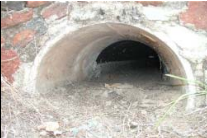
横断函渠の堆砂状況 管径は600mm
