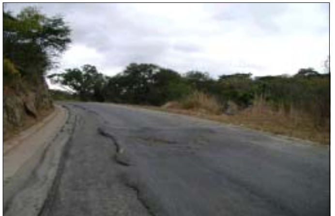
キトンガ峡谷の舗装 (KP 446+500) 峡谷区間7.5kmはほぼ全線に亘って 轍掘れが発生している
