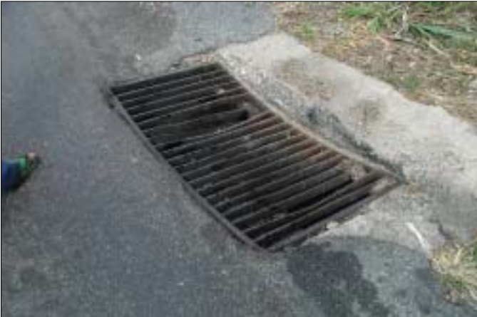
排水柵のグレーチング蓋の損傷 重貨物車輛の通過による蓋の損傷・損失が多い
