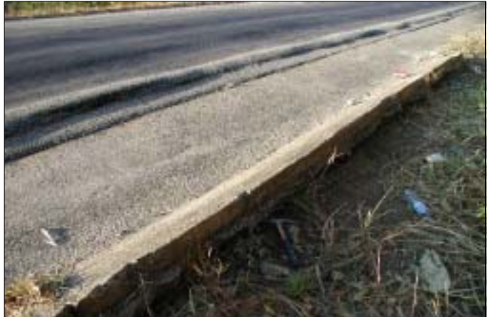
山側側溝背面の雨水による沈下・浸食
