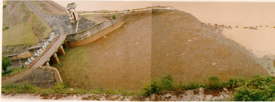
洪水吐き及び取水口前面の塵芥
