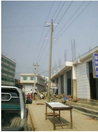
コンクリート柱の配電線
