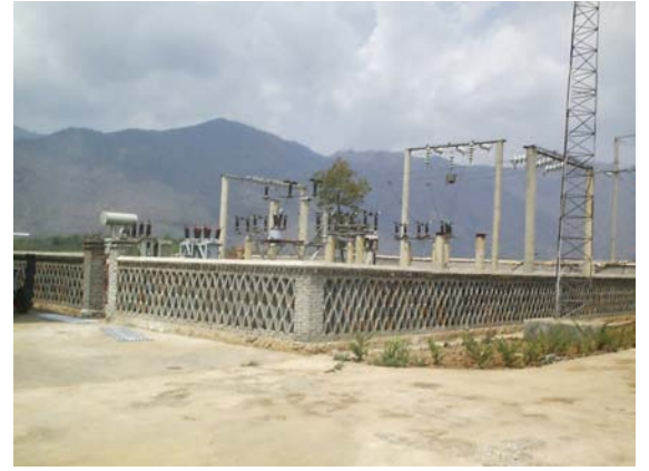
コーカン変電所屋外変電設備
