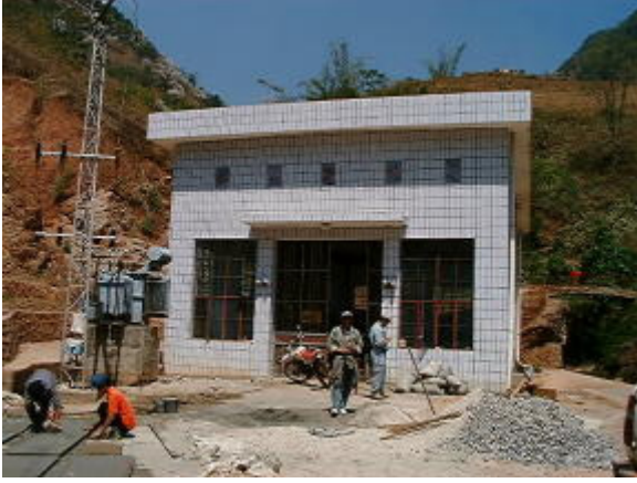
ロンチン水力発電所建屋
