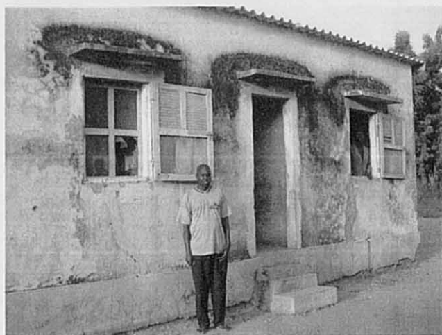
写真-32 ンベラ・カディアオ保健ポスト 建物は老朽化が激しい。
