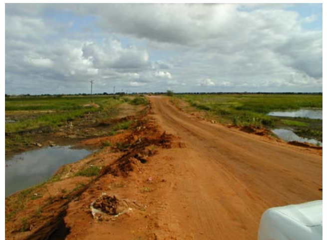
写真24 豪雨によって損壊した幹線国道
