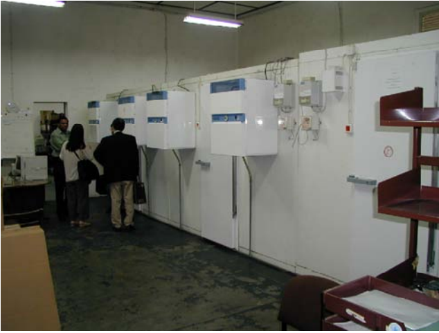
写真1 保健省ワクチン倉庫 2台の冷蔵室、1台の冷凍室を有している。
