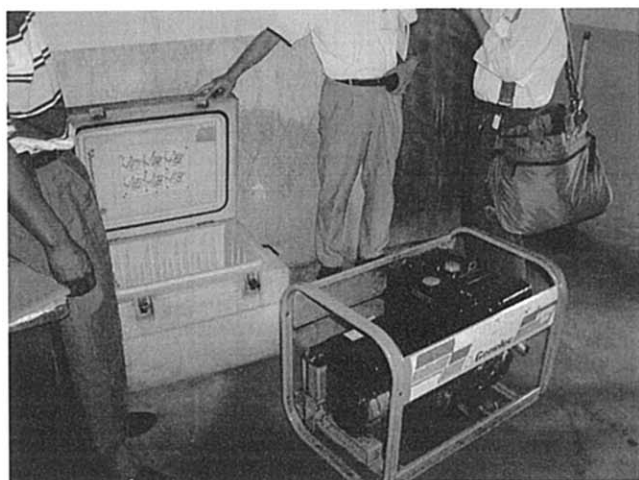
写真-24 Baoro郡病院の発電機 2000年にEUより供与された。それ以前、電源(公共配電)は全くなかった。
