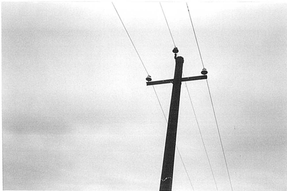
10 k V送電線 (引き通し柱)
