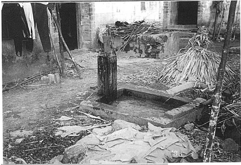
共同で利用されている手押しポンプ付き浅井戸
