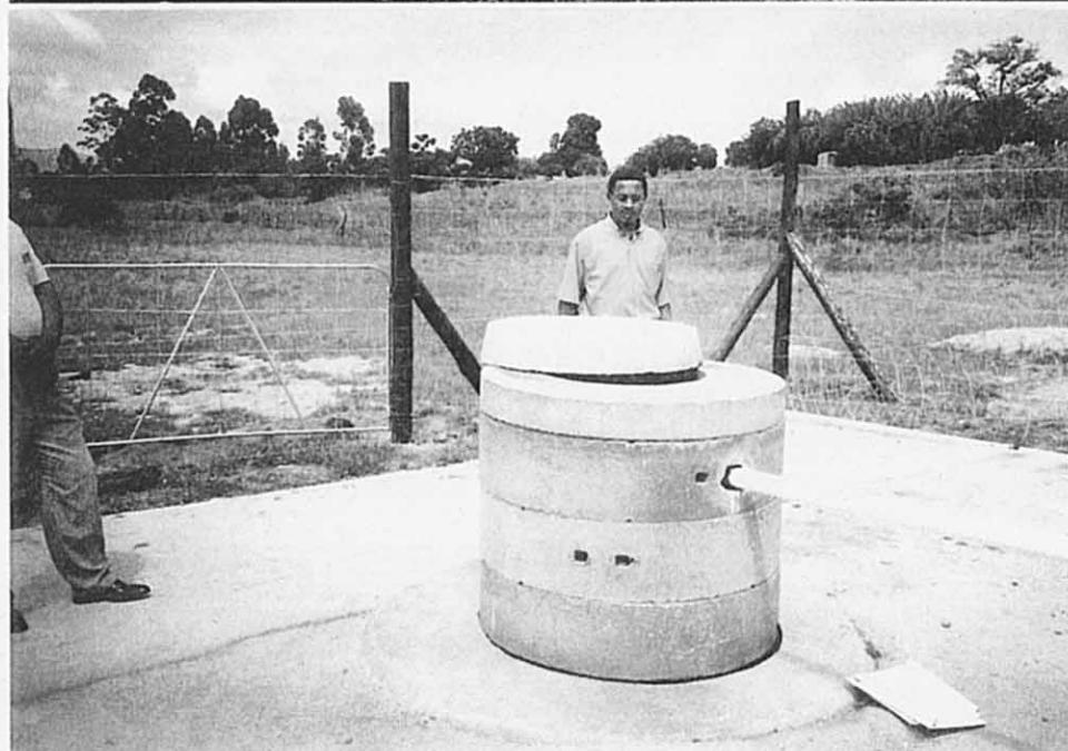
写真12 第1次地方給水計画事業 供与さく井機械により RWSB独自によって建設 したマクロスキーム用 井戸（外観） Manzini 県 Ludzeludze 1
