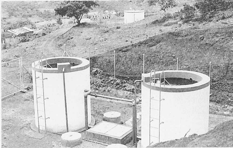
写真4 第1次地方給水計画事業 マクロスキーム緩速ろ過池 Hhohho 県 Msumpe
