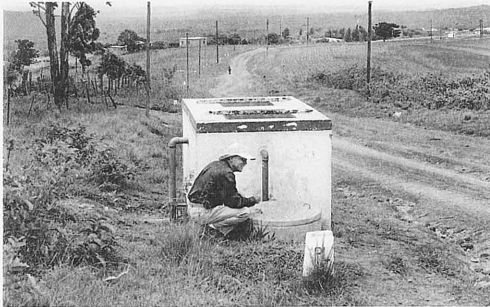
写真5 第1次地方給水計画事業 マクロスキーム減圧タンク Hhohho 県 Bekhinkosi
