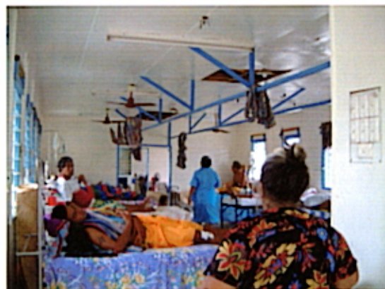
▲男子病室内 病棟内は、開口部(窓)が少なく、自然通気が十分でなく暑い。また、老朽化(雨漏り)による天井破損も見られる。
