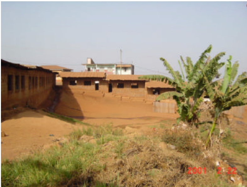
DJELENG 3 小学校 (BAFOUSSAM) 降雨により表土が流出し、敷地がす り鉢状にえぐられている。
