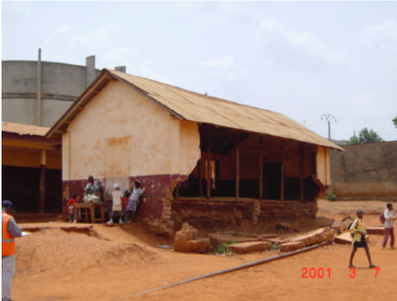
PLATEAU ATEMENGUE 小学校 雨により土が削られ基礎が崩壊して しまった校舎。
