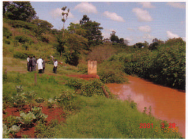
JKUATの現在の取水口付近。シルトの堆積により維持管理が難しい状況となっている。
