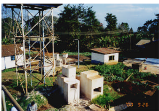
塩素滅菌施設および逆洗浄タンク
