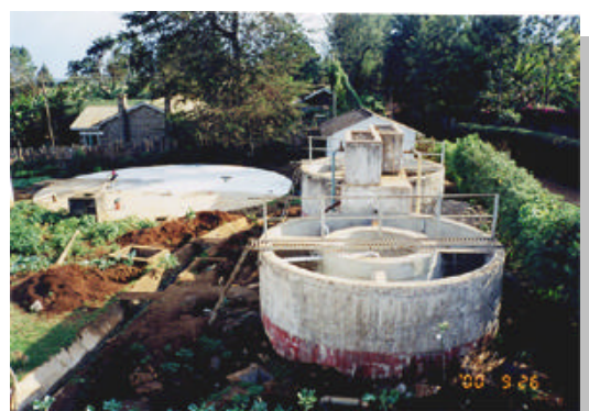
1952年に建設された沈殿・濾過複合ユニット
