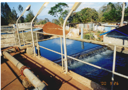
ミリマニ浄水場内直接濾過池
