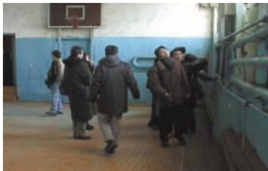
中学校を視察する調査団。体育館は暖房が壊れ冬は使えない状態（モンゴル）
