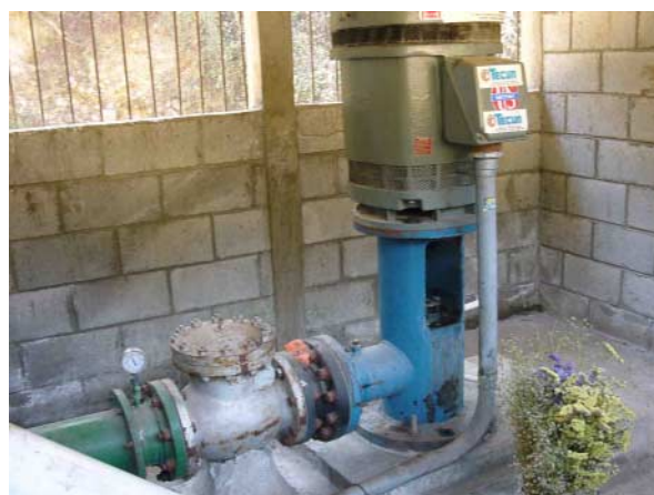
La bomba para suministro de agua (aproximadamente 900 hogares en Palestina de Los Altos reciben agua desde este sistema)
