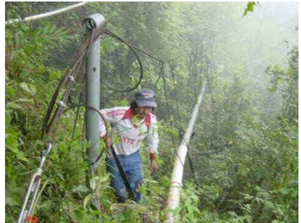
El tubo para suministro de agua cerca de nacimiento (la piedra daña el tubo fácilmente por que el tubo está mal instalado)
