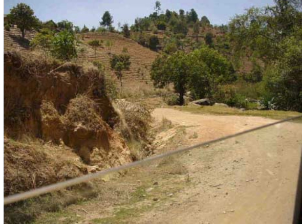
Condición del camino en la comunidad
