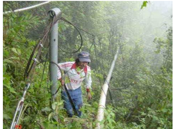
水源付近の水道給水管（不十分な施設の為、落石等で壊れやすくなっている）
