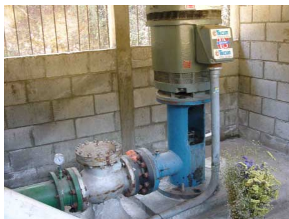
水道供給に使用しているポンプ（パレスティナ地域約 900 戸に給水している）
