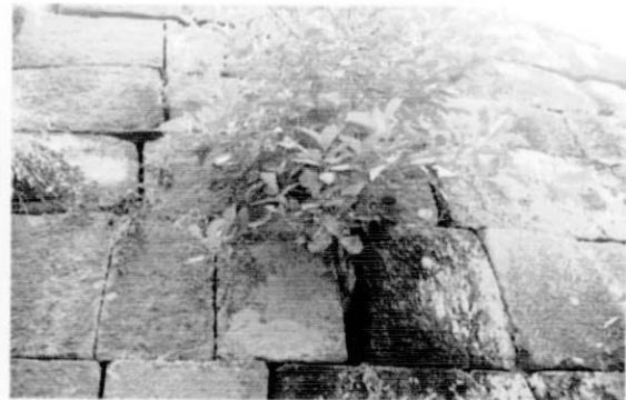
建築物への植生による被害
