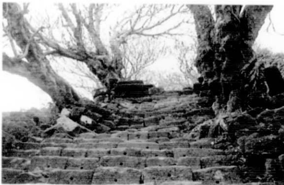
参道の植生による被害
