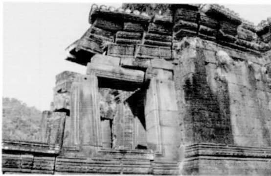
崩落の危険性を有する北宮殿入口部
