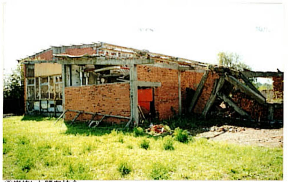
②崩壊した既存校舎
