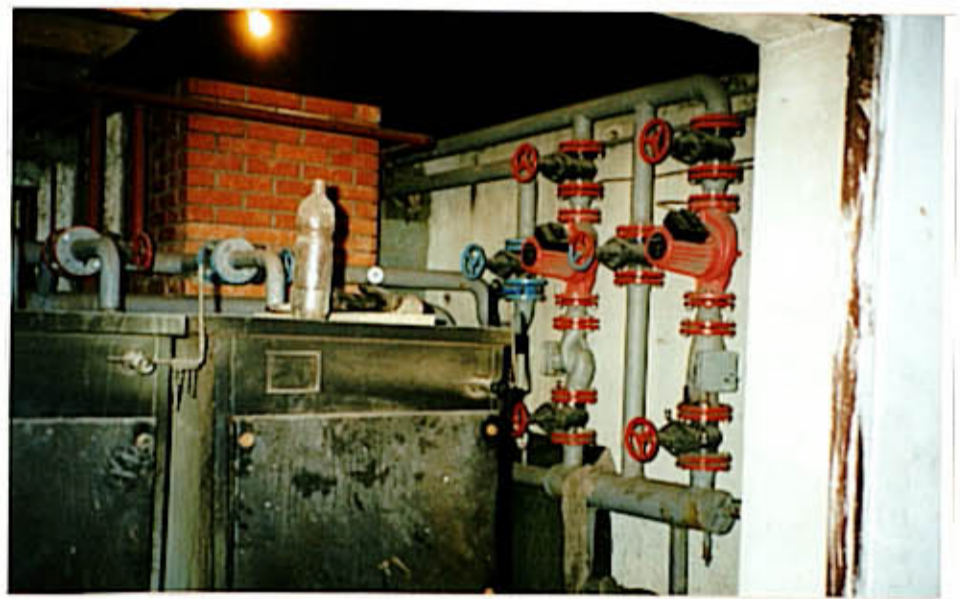
⑤ 同左石炭ボイラー
