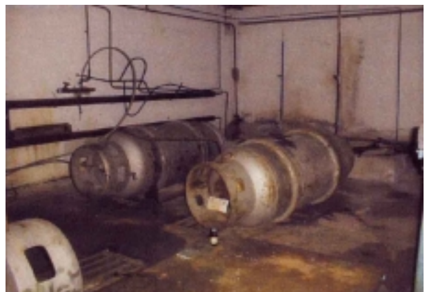
塩素ポンペ (配水池塩素貯蔵室)
