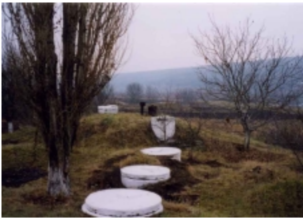
井戸集水施設 (地下タンク式)
