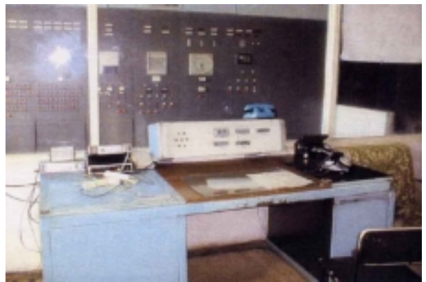
浄水場 中央制御室 (運転休止施設)
