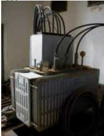
受電設備 - その2 壊れた変圧器はそのまま放置されている
