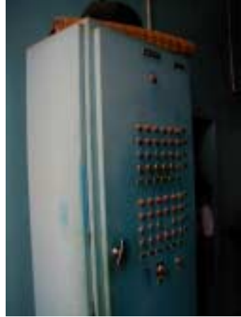
薬品注入設備制御盤 - その1
