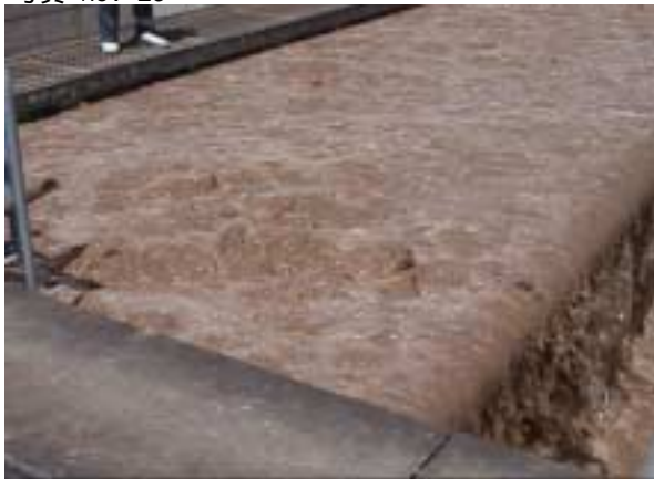
ろ過池 - 空気+水 洗浄中 手前側から空気が大量に吹き出しており、 集水装置が壊れていると思われる
