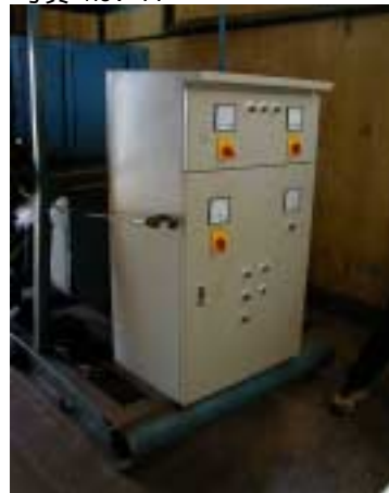
自家用発電機設備 - その2 制御盤 2000年6月に外から雨が降り込んで、 盤内に水滴が入り、ショートしてしまった 2000年7月に新しいものと取り替えた
