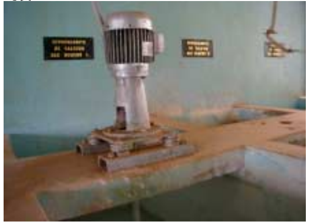
消毒剤注入設備 - その2 No.1槽のみ使用されている
