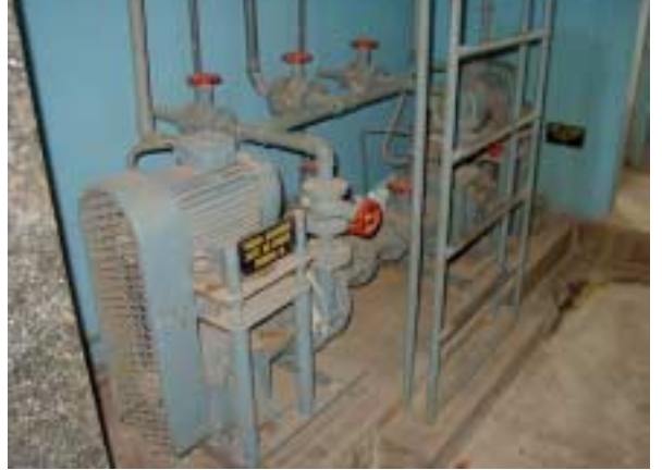
アルカリ剤注入設備 - その3 溶解用循環兼溶液ポンプが2台設置されている 現在使用されないまま放置されている
