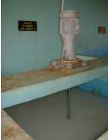
凝集剤注入設備 - その1 攪拌機はNo.1槽にはある
