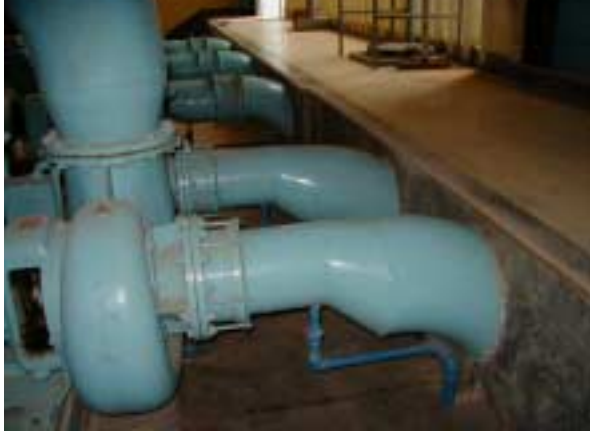
ろ過池逆洗ポンプ - その2 呼び水が吸込管に吐出ヘッダー管と場内用水ポンプ圧力 タンクから常時循環されており、いつでも起動可能である
