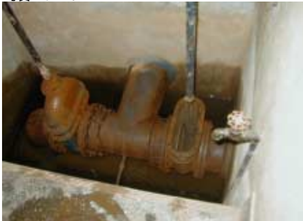
ろ過池流出弁、ろ過池逆洗弁及び配管 ピット内に水が溜まっているところもあり、 弁外面のほぼ全面に錆が発生している
