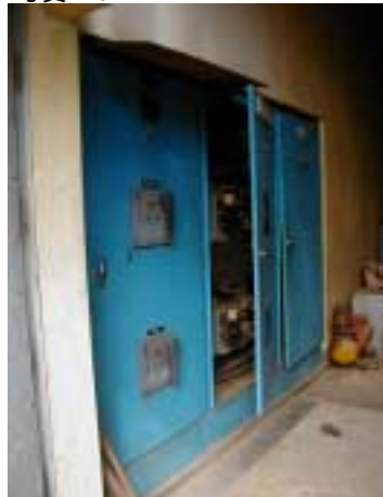
受電設備 - その5 現在使用されている
