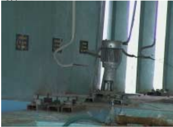
消毒剤注入設備 - その1
