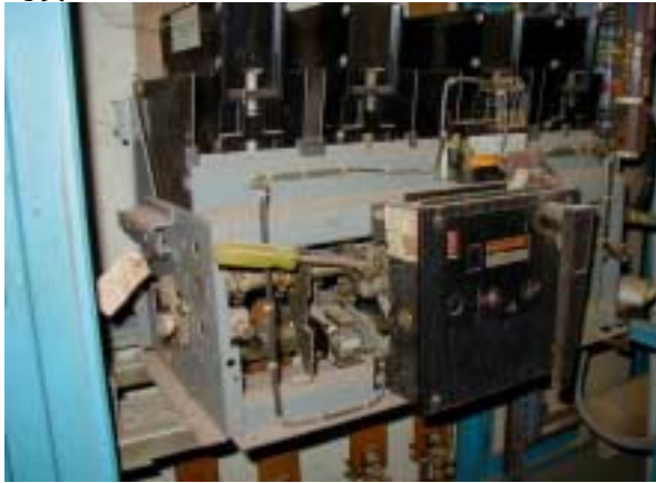
配水ポンプ制御盤 - その4 盤内のスイッチギアレバーをドライバーで代用しており危険である
