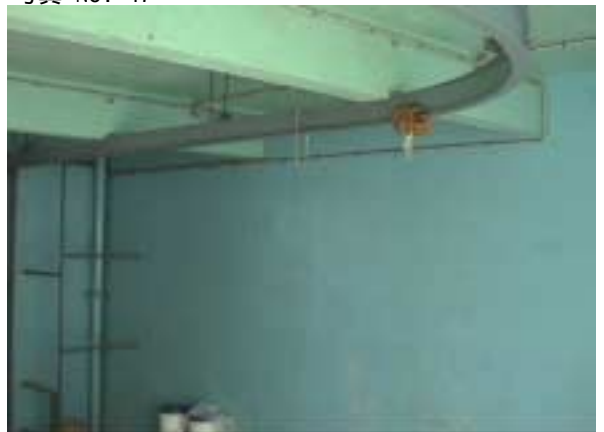
天井クレーン 天井クレーン用レールはあるが、ホイスト本体がない
