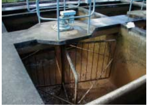
フロック形成池に設置された緩速攪拌機 その4
