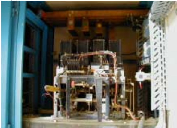
受電設備 - その8 現在使用されている 盤内のスイッチギアレバーをドライバーで代用して おり危険である
