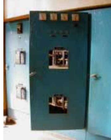
受電設備 - その7 現在使用されている
