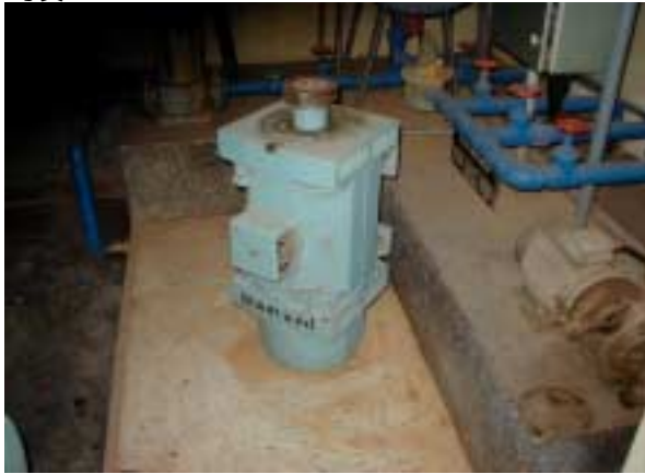
ろ過池逆洗ポンプ - その4 電動機が1台故障している
