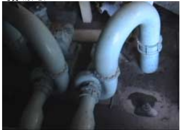
ろ過池逆洗ポンプ - その1 吸込管にフート弁が付いている
