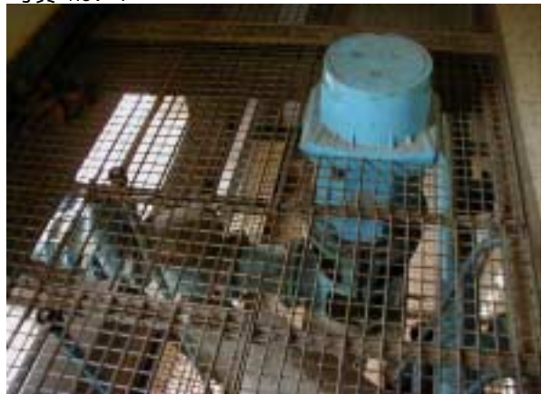
ナケ浄水場取水塔内 グレーチング床、取水ポンプ
