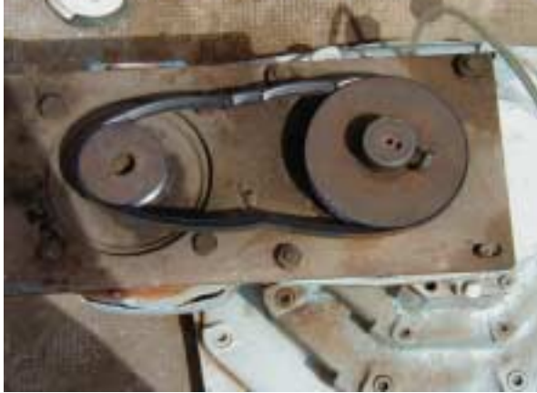
フロック形成池に設置された緩速攪拌機 その3 Vベルトが切れかかっている
