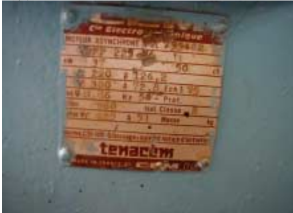
取水ポンプの銘板
