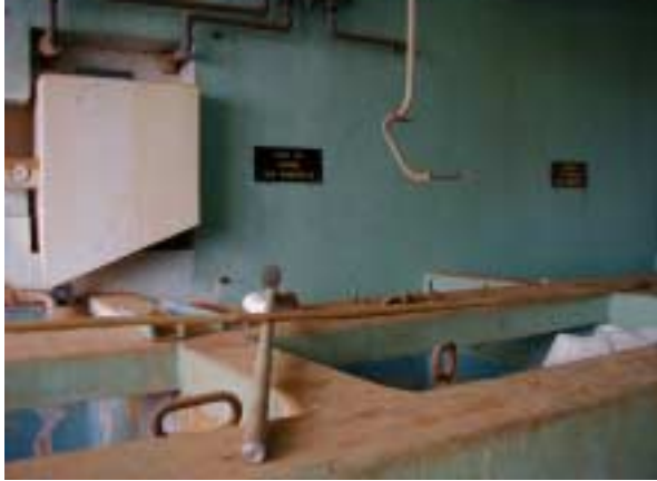
アルカリ剤注入設備 - その2 2槽とも使用されていない 攪拌機も取り外してある
