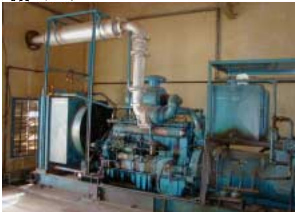
自家用発電機設備 - その1 毎月の保守運転を実施している 調速装置の調整が必要であるが、状態はよい
