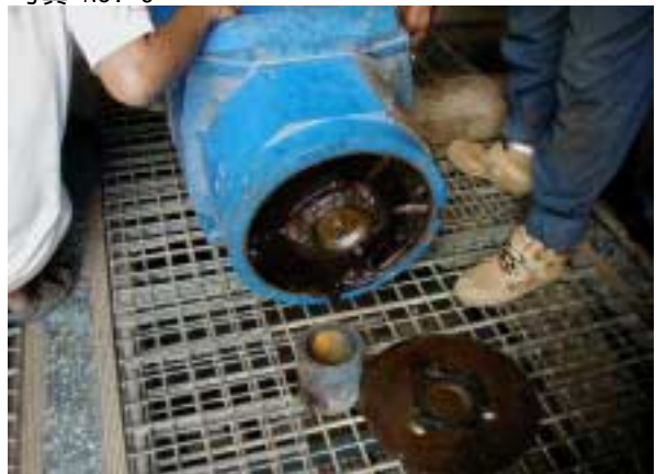
調査中の10月24日にNo.3取水ポンプの電動機が 過負荷で故障
