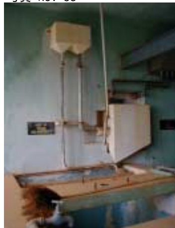
アルカリ剤注入設備 - その1 2槽とも使用されていない 攪拌機も取り外してある 1984年に使用をやめた
