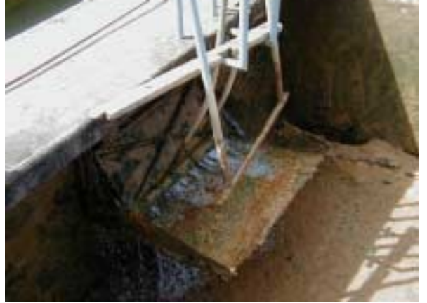
ろ過池流入ゲート 全体的に錆が発生している
