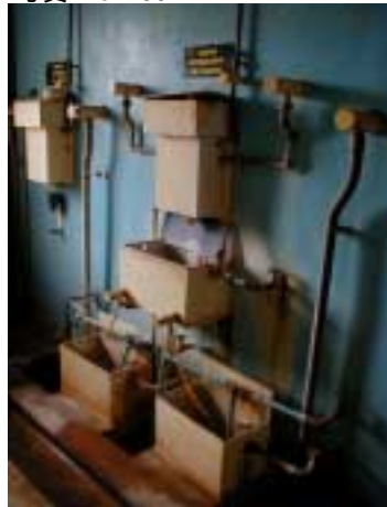
消毒剤注入設備 - その4 注入器
