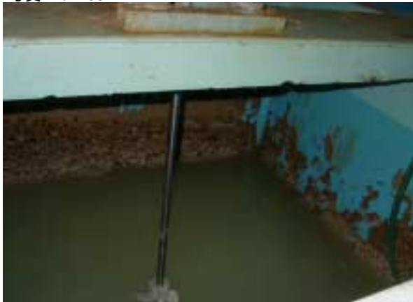
消毒剤注入設備 - その3 溶解槽の内面は劣化している
