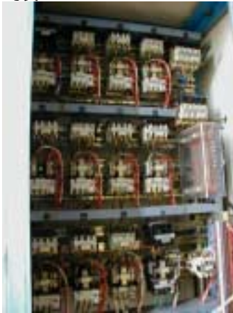
薬品注入設備制御盤 - その2
