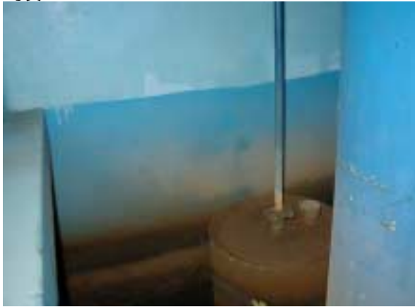
ろ過流量調節装置 - その4 ろ過流量調節用フロート 水中部のほぼ全面に錆が発生している
