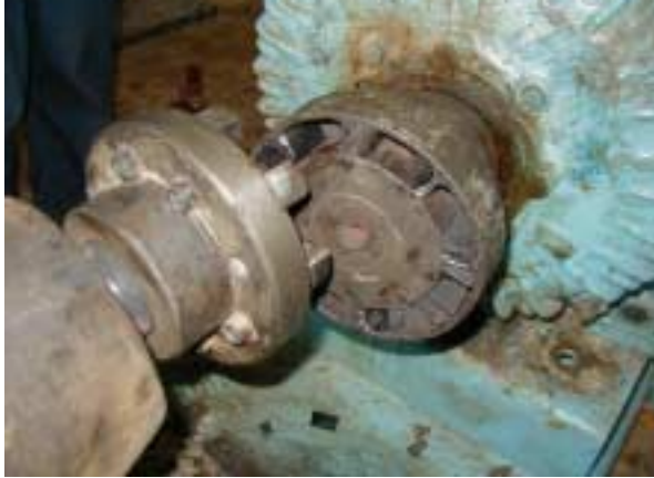
配水ポンプ - その4 シャフトカップリングのゴム材がよく壊れる
