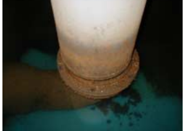
ろ過流量調節装置 - その3 ろ過流量調節部 水中部のほぼ全面に錆が発生している
