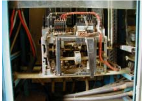
受電設備 - その9 現在使用されている
