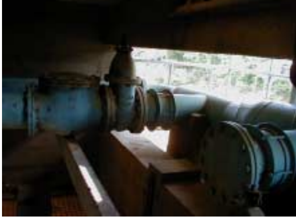
ナケ浄水場取水塔内 取水ポンプ及び配管 その1
