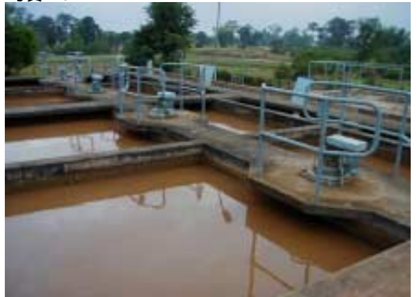
フロック形成池に設置された緩速攪拌機 その2
