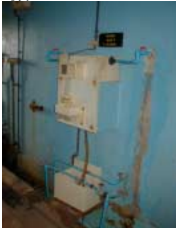
凝集剤注入設備 - その3 注入器は使用されている
