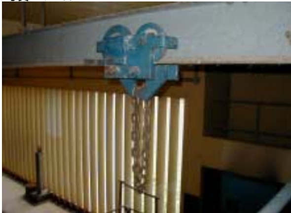
天井クレーン 手動式ホイストクレーンである 壊れている
