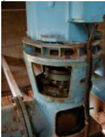
ナケ浄水場取水塔内 取水ポンプ、 電動機
