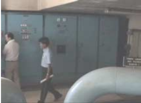
配水ポンプ制御盤 - その2
