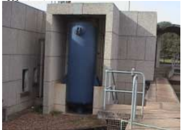
エアチャンバー ウォーターハンマー対策として設置されている 外観は良好である
