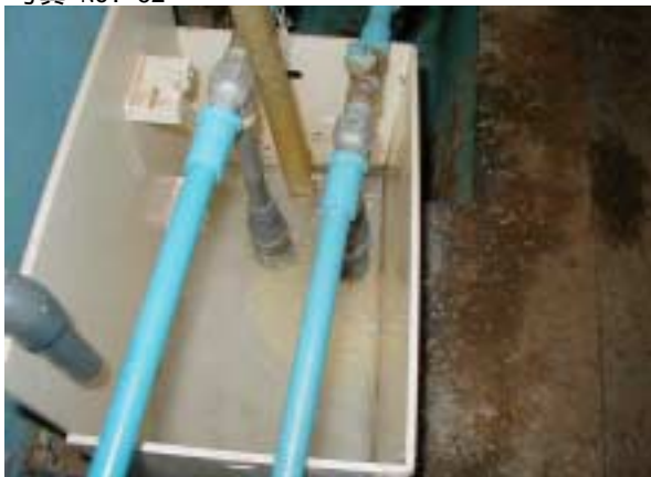
凝集剤注入設備 - その5 希釈水が注入されずにいるため液位が下がり、 エジェクタが空気を吸い込む
