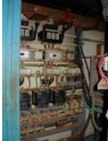
配水ポンプ制御盤 - その3 計器は老朽化している
