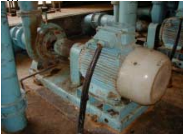
配水ポンプ - その2 たびたびの故障のため、塗装されずに錆びている
