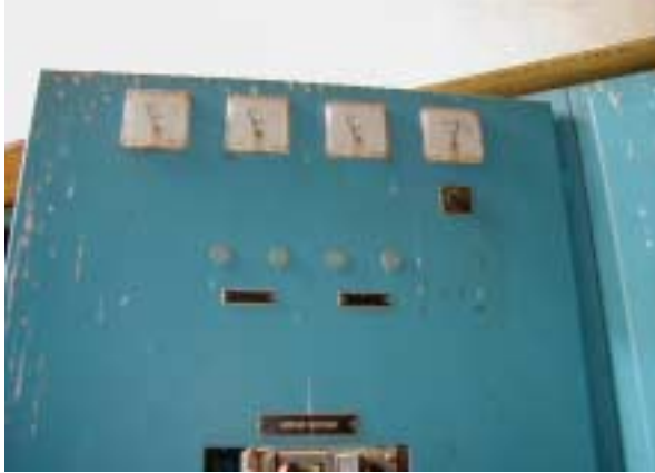
受電設備 - その6 現在使用されている
