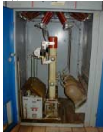
受電設備 - その3 使用されていない受電盤
