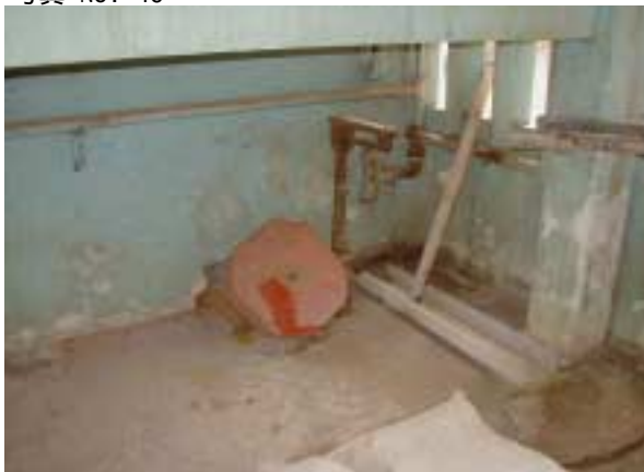
計量機 壊れたまま放置されている 1988年以降使用していない
