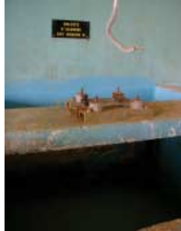
凝集剤注入設備 - その2
