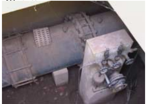
配水ポンプ - その3 浄水場内の配水管に取り付けられたオリフィス式流量計 壊れている
