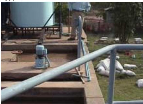
混和池に設置された急速攪拌機 その1 混和池に注入されるポリマー水溶液
