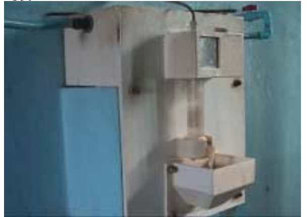
凝集剤注入設備 - その4 注入器
