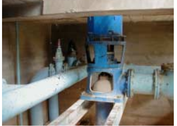
ナケ浄水場取水塔内 取水ポンプ及び配管 その2
