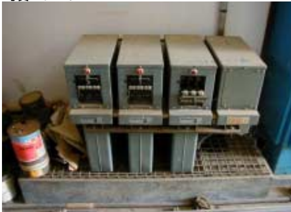
受電設備 - その4 現在使用されている
