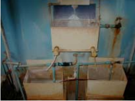
消毒剤注入設備 - その5 エジェクタに空気が吸い込まれている
