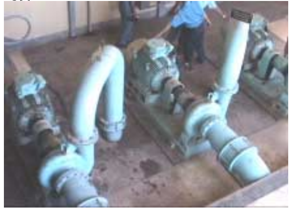
配水ポンプ - その1 吐出配管がサポートされておらず、振動している 吐出圧によるスラストが掛かるので、危険である
