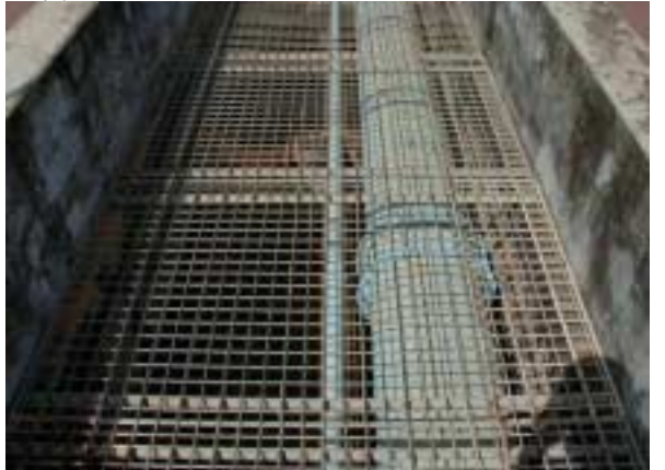
取水塔ポンプ室から導水管橋までのスパイラル溶接管と接続に使用されているドレッサータイプのフレキシブル・ジョイント
