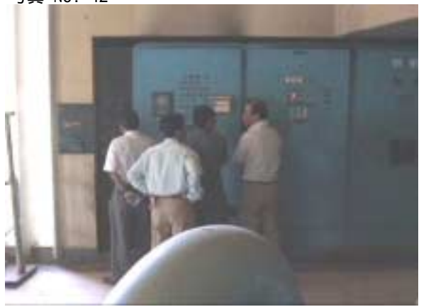
配水ポンプ制御盤 - その1
