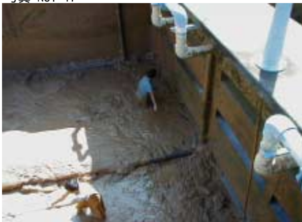
沈殿池排泥弁 その2 水中にある弁軸は曲がり、錆びている
