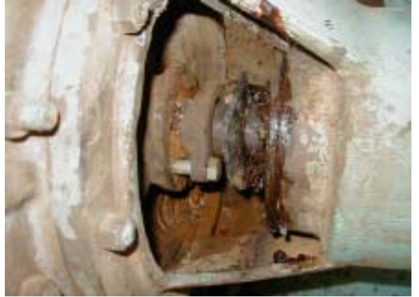
配水ポンプ - その5 グランド部は全面錆が発生している
