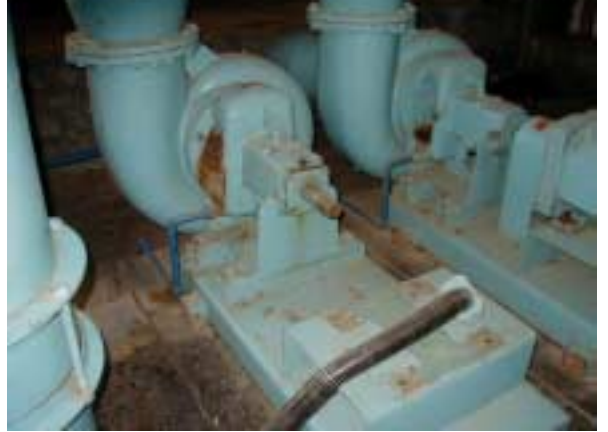
ろ過池逆洗ポンプ - その3 電動機が1台故障している
