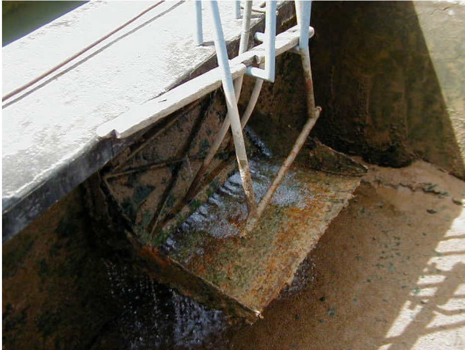
写真 7 ナケ浄水場内の様子(3) ろ過池流入ゲート 全体的に錆が発生している
