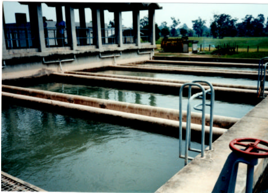
写真 6 ナケ浄水場内の様子（2） ろ過池近景
