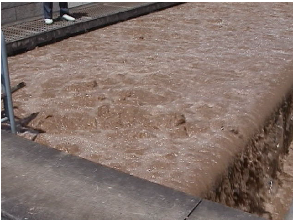
写真 8 ナケ浄水場内の様子(4) ろ過池洗浄の様子 手前側から空気が大量に吹き出しているのは、集水装置が故障していることによるためと考えられる
