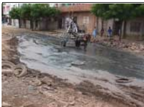
Mauvaise maintenance de routes
