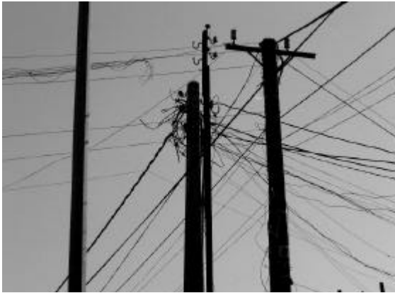
サン・パウロ局エリア 電話線と電力線との交叉
