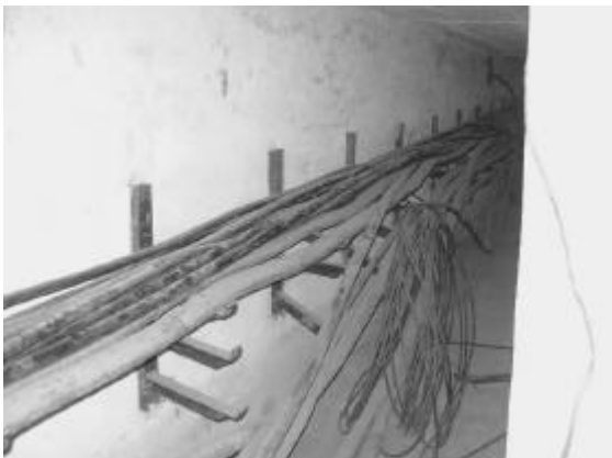
サン・パウロ局 局内マンホール
