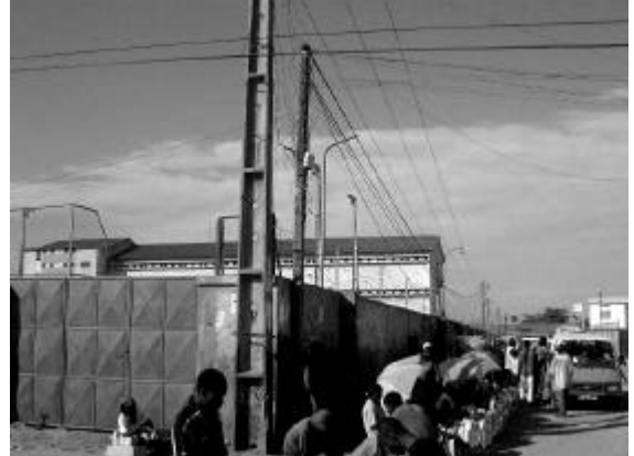
テラ・ノヴァ局エリア 高圧電力ケーブルの引上用の柱
