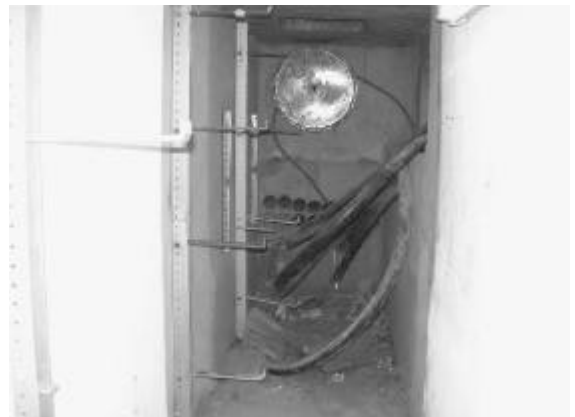
テラ・ノーヴァ局 局内マンホール
