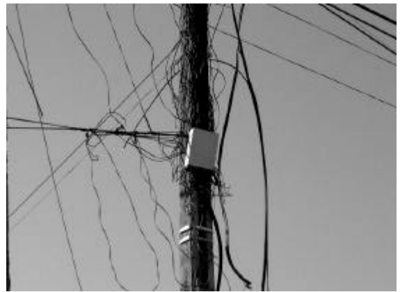
テラ・ノーヴァ局エリア 既設端子函の状況
