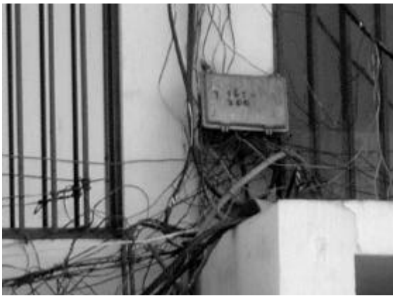
サン・パウロ局エリア 既設端子函の状況
