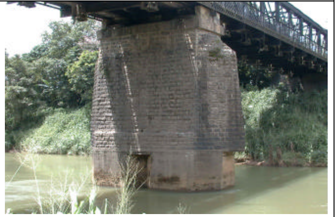
橋脚現況（洗掘状況）
