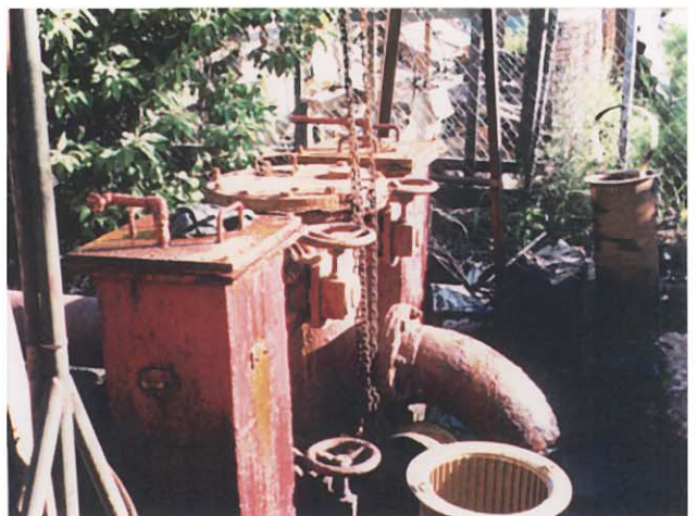
海水冷却システム
