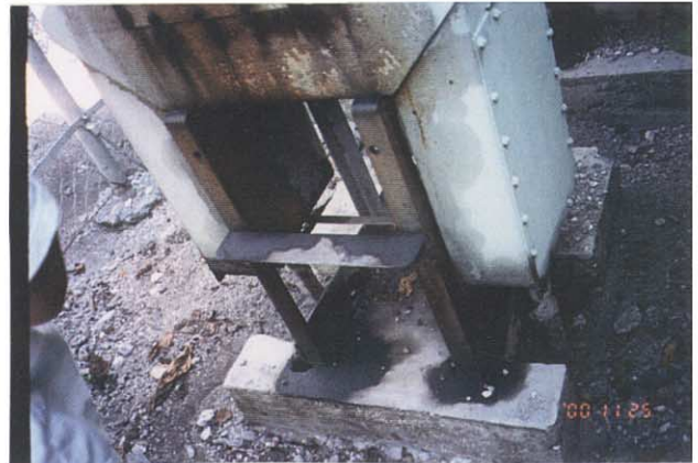
既設配電用開閉器盤の高圧ケーブル処理箱
