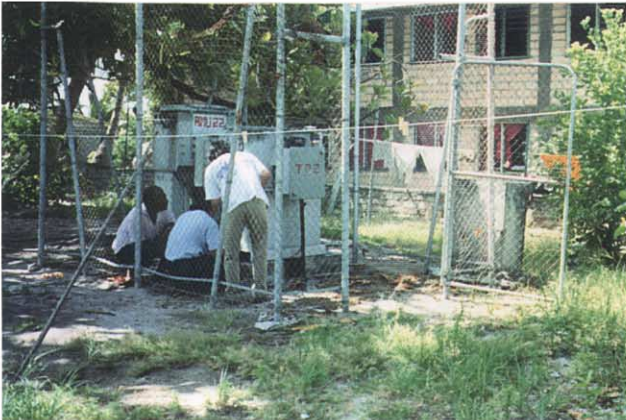
既設配電用変電所
