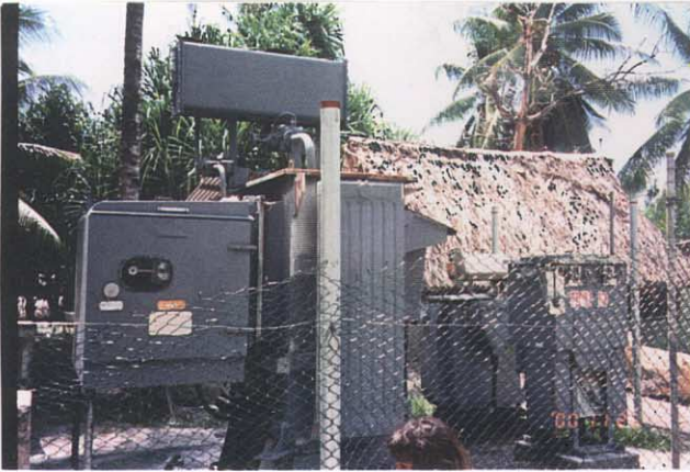
既設電圧調整器
