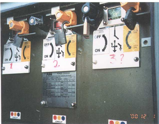
既設配電用開閉器盤
