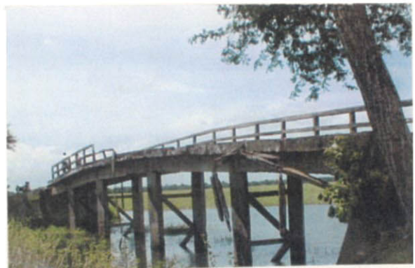
損傷が激しく車輛通行止めになっている。 橋梁番号 101026
