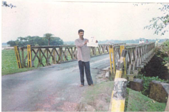
橋台が破損し、老朽化した桁も変形している。 橋梁番号 201342
