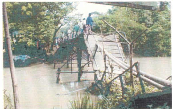
腐食が激しく崩壊している。 橋梁番号 700844
