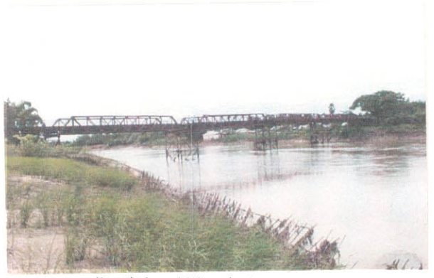
桁は腐食し、橋脚は沈下している。 橋梁番号 201011
