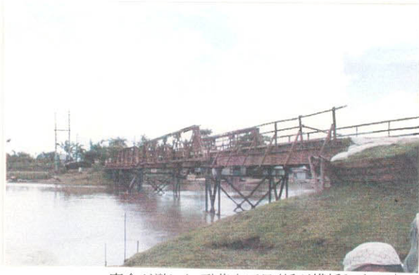
腐食が激しく、耐荷力不足(橋が横揺れする。) 橋梁番号 200975
