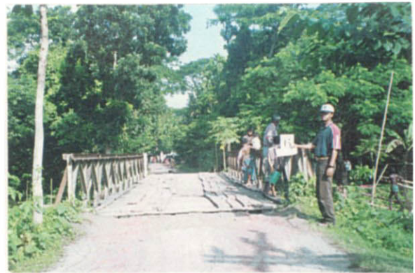
床版が破損し桁も老朽化している。 橋梁番号 700416
