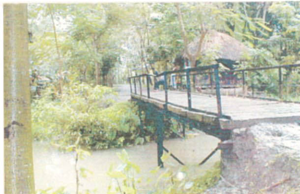
幅員が狭く、耐荷力不足 橋梁番号 700806
