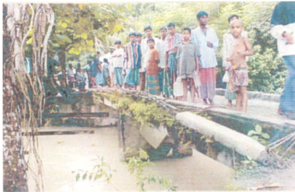
鉄筋が露出し、腐食している。 橋梁番号 700853
