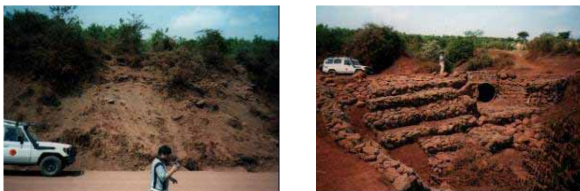
図 2-3. 斜面の浸食状況 (55km 地点)
