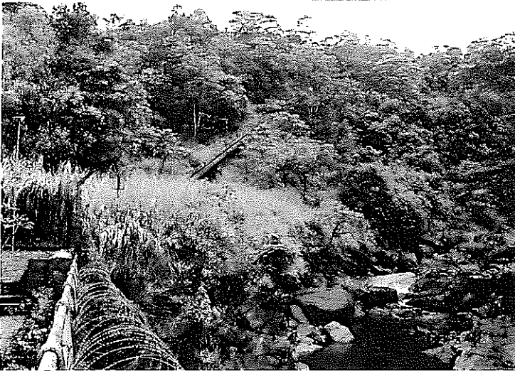
New Laxapana 発電所の水圧管路下部
