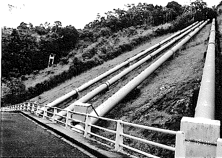
Old Laxapana 発電所の水圧管路下部
