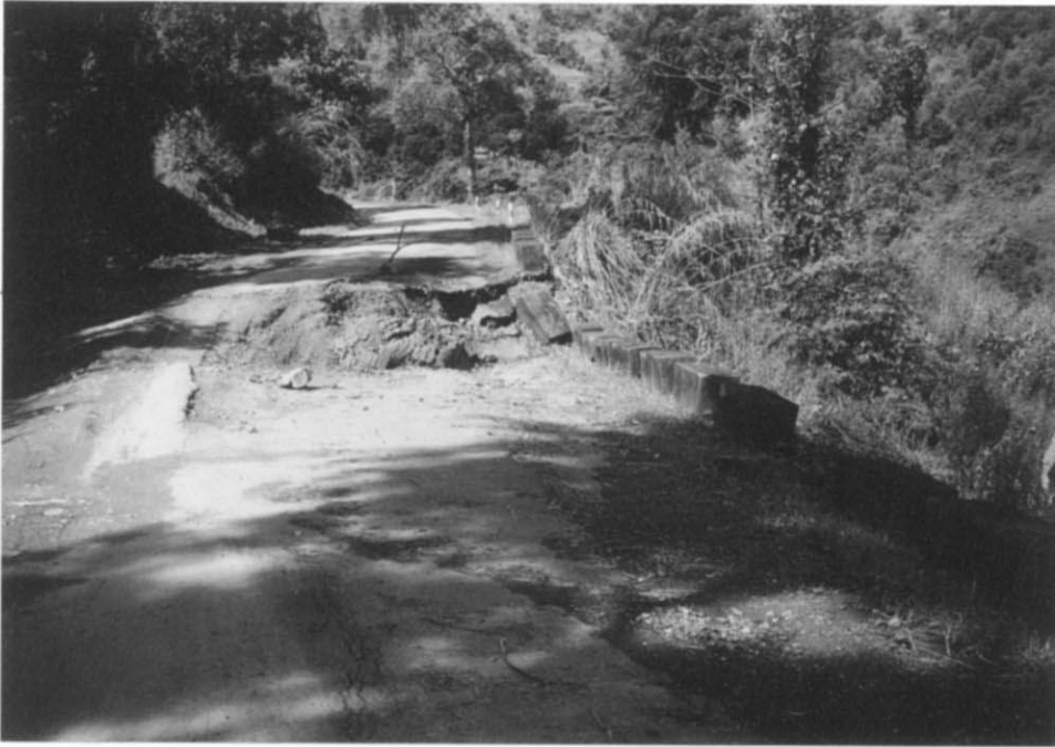
道路が陥没している
