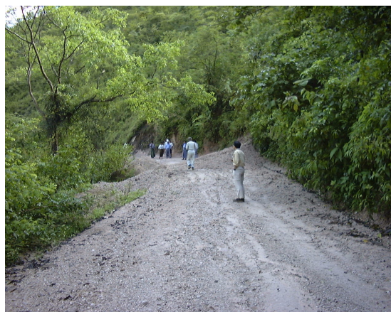
写真②: 34 号線の土砂崩れ多発区間
